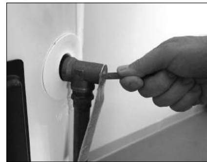
Figure 38 - Soupape de décharge DST
